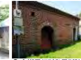
⑨ 永瀬電灯所発電所跡 川口鑄物の近代化に尽力した永瀬庄吉が、明治33年(1900)に埼玉県で最初に発電事業をおこなった発電所の建物。個人の邸内にあるため見学不可。門の外からは見ることができません。
